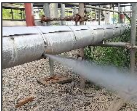
Purgas y fugas de vapor (silbidos)
